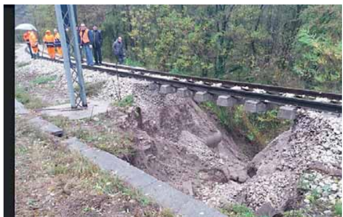
La linea danneggiata da uno smottamento nei pressi di Mezzolombardo
