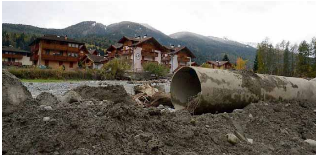
La frana ha anche divelto le tubature
