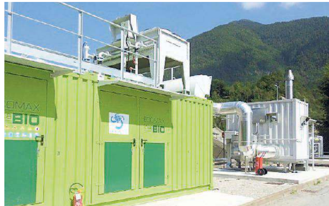
L'impianto di biogas della Geas nella discarica comprensoriale di Zuclò
