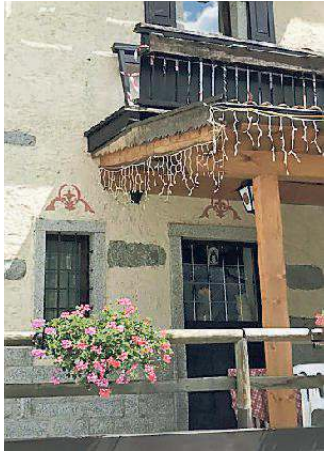
Un pezzo di parapetto si è staccato
