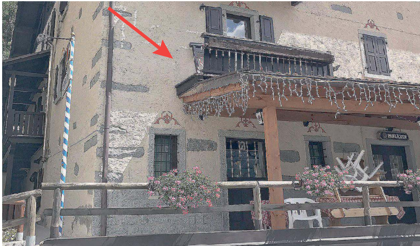
Il ristorante pizzeria la Civetta di Massimeno. La freccia indica la parte di parapetto che ha ceduto. Il poggiatesta è stato sequestrato (foto Paolo Bisti)
